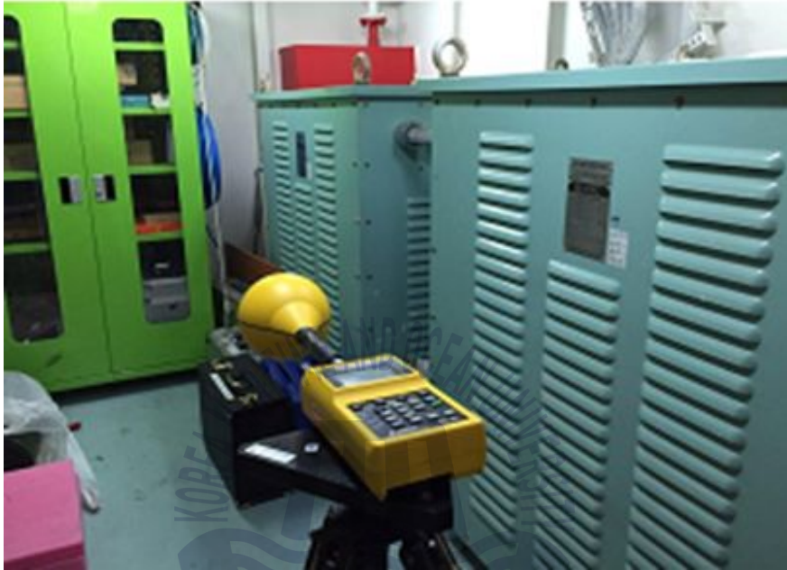
그림. 3-7 한바다1호 시험 설치(TR Room) Fig. 3-7 Test setup in the ship (TR Room)
