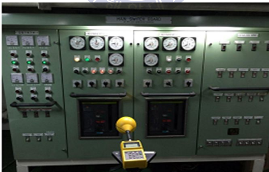
그림. 3-10 차도선 시험 설치(배전반) Fig. 3-10 Test setup in the ship(Switchboard)
