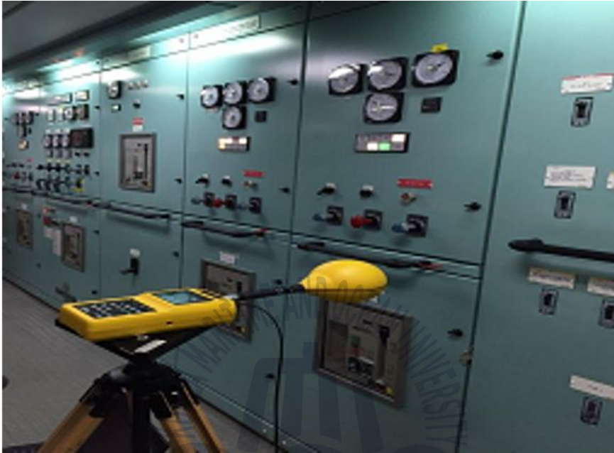
그림. 3-6 한바다 호 시험 설치(배전반) Fig. 3-6 Test setup in the ship(Switchboard)
