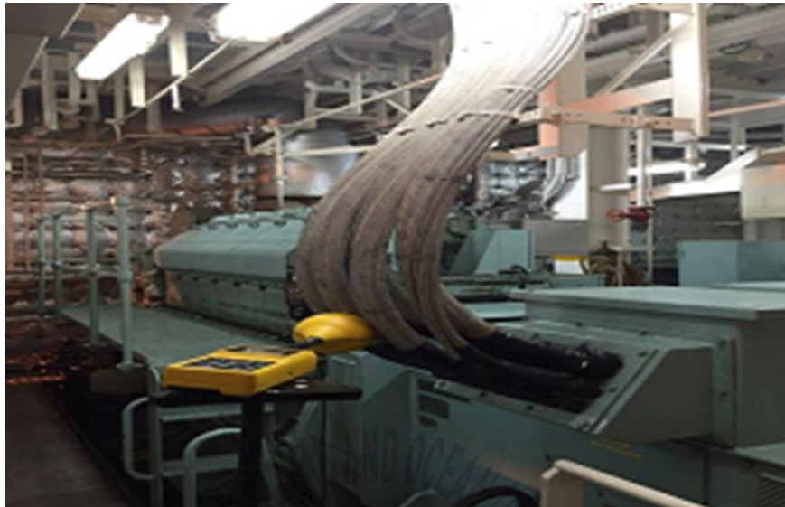
그림. 3-8 한바다 호 시험 설치(발전기실)
